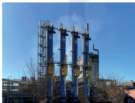
Traitement des gaz par les amines
