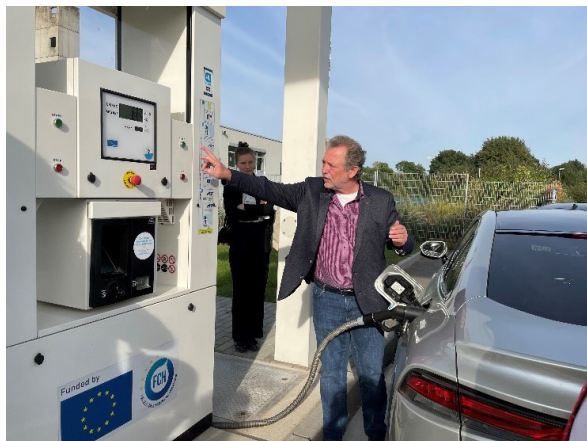
Plein d'hydrogène à la station d'Herten
