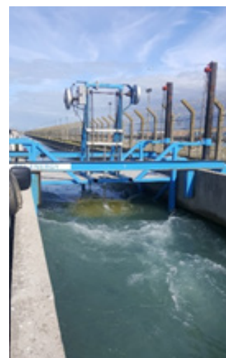
Installation EEL Energy sur le canal d'Aquanord
